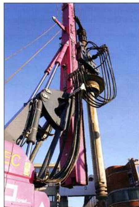
L'antenna, di tipo automontante, è composta da un elemento intermedio della lunghezza di 14,5 m, un elemento inferiore da 2,8 m e una prolunga da 1,5 m
